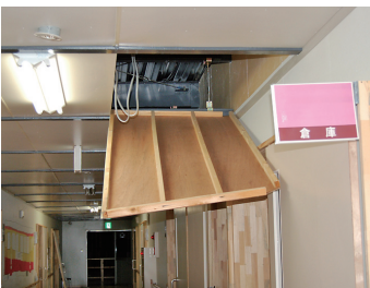
仮設病棟の剥がれかかった天井板。廊下や室内など仮設病棟内のさまざまところで天井板が剥がれた
