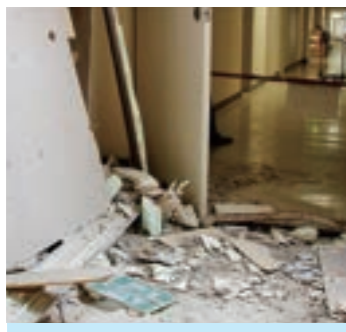
剥がれ落ちたコンクリート片。建物の棟と棟のつなぎ目では、特に壁が激しく崩れた
